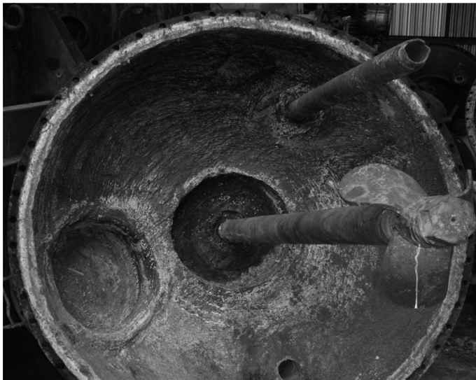
Рисунок 2 - Крышка аппарата позиции 13, которая была предварительно обработана перекисью водорода и покрыта ингибирующим раствором с добавлением активатора адгезии (NiO), после 30 сут непрерывной работы аппарата
